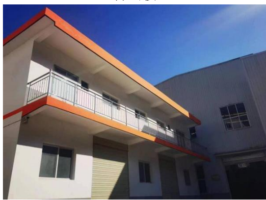
一层机修车间、二层球磨、浮选配电室
