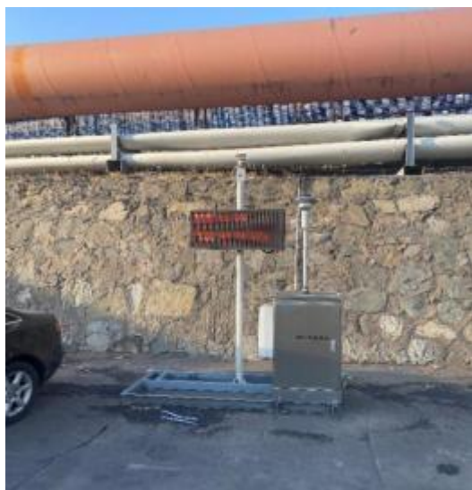
面煤棚颗粒物监测装置
