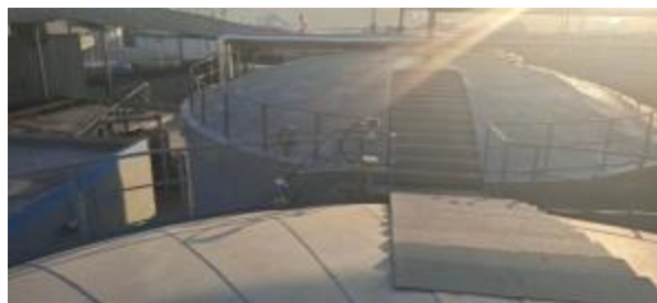
罐区液位报警器
