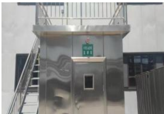
西侧在线监测装置
