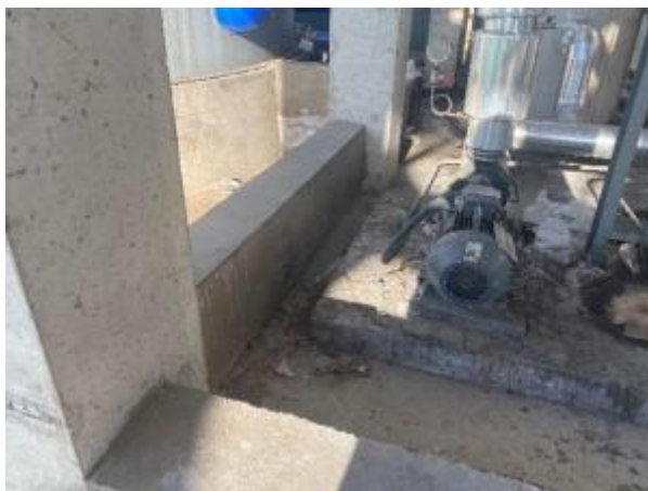
蒸氨装置围堰
