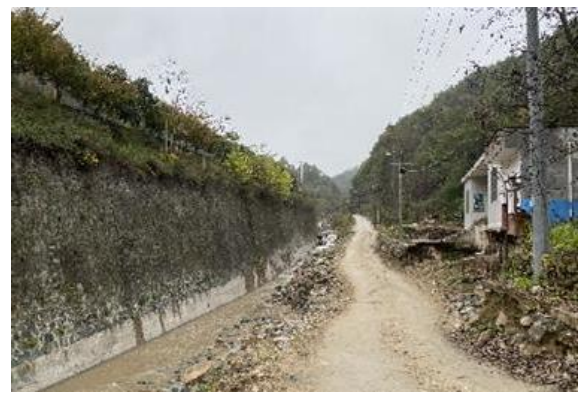
K1564+200 主线西侧水毁实拍
