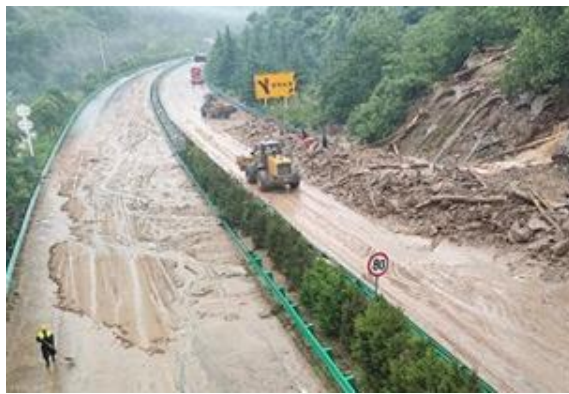
K1564 豹子沟隧道出口灾害实拍
