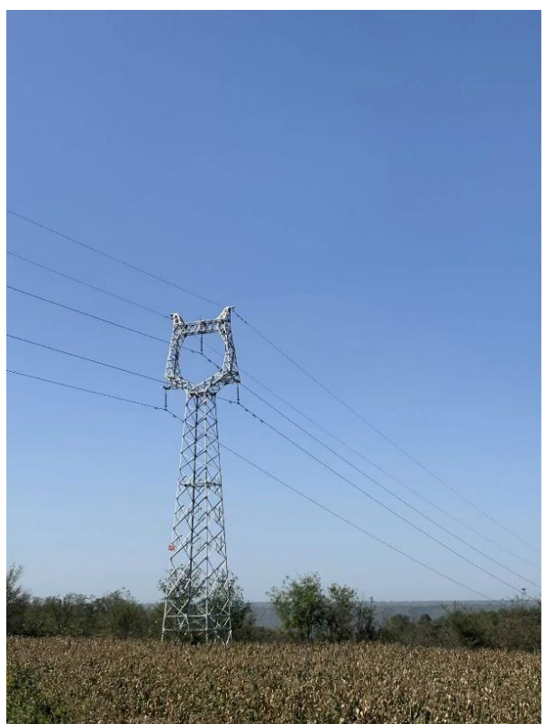
延安市富县龙王庙村附近塔基
