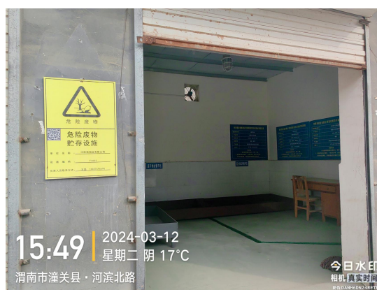
危废贮存间导流槽
