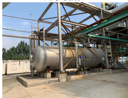
碱液储罐及围堰
