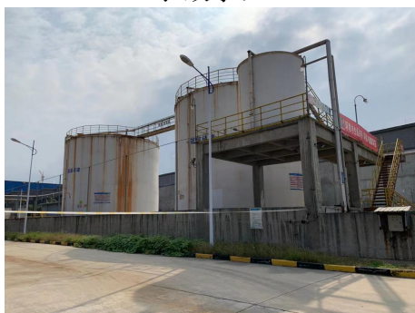
硫酸储罐及围堰
