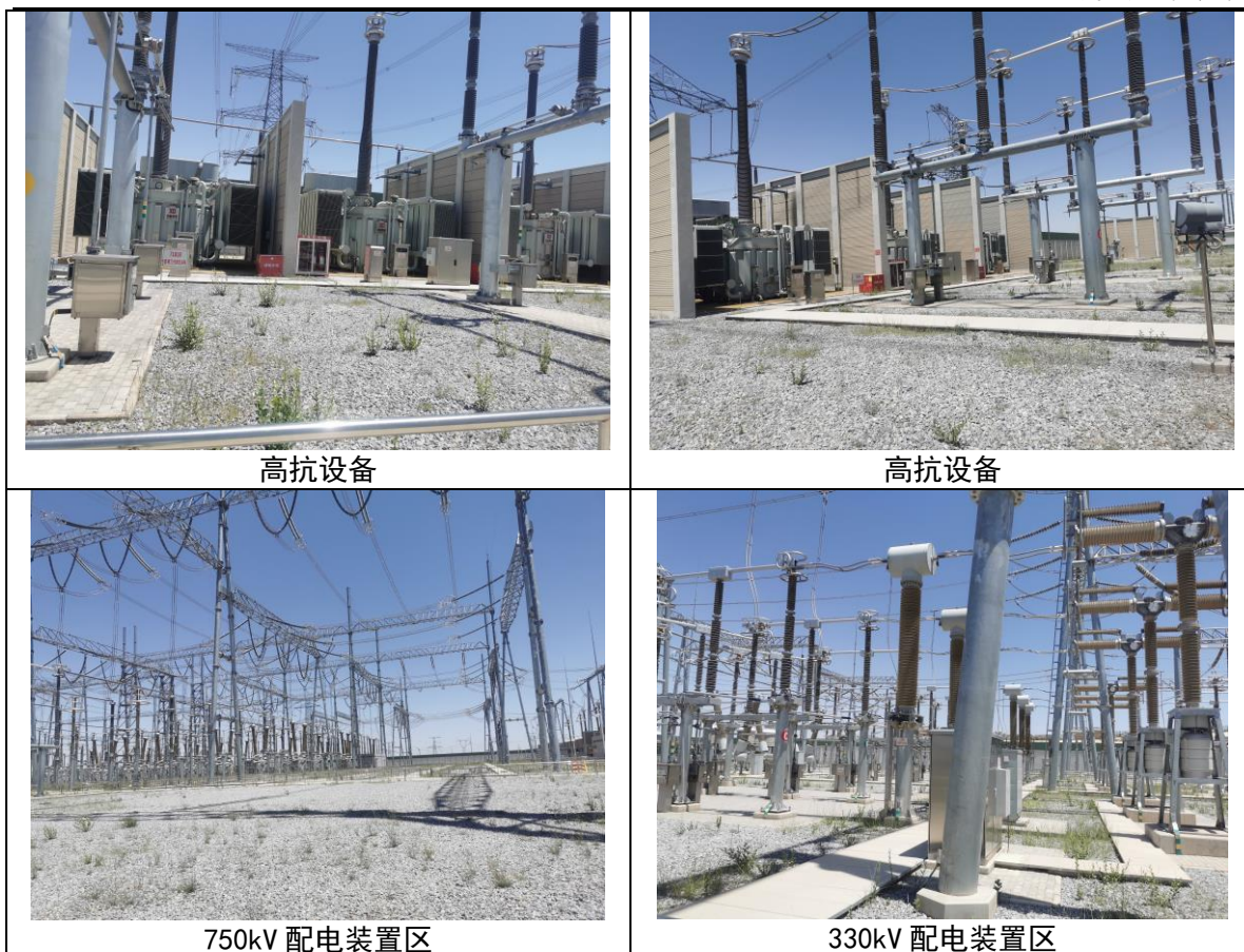
图 3.1-3 定靖（夏州）750kV 变电站现状照片
