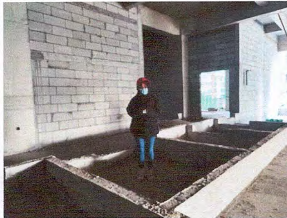
综合医院介入手术室 1 清洁间
