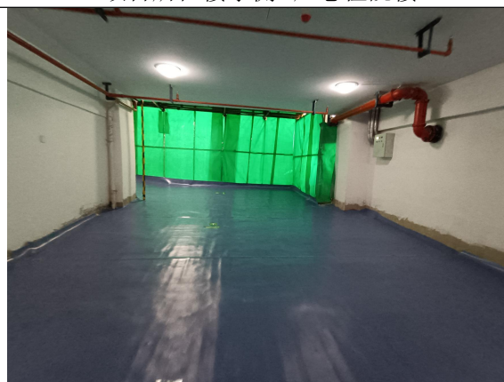
后装机房北侧大厅
