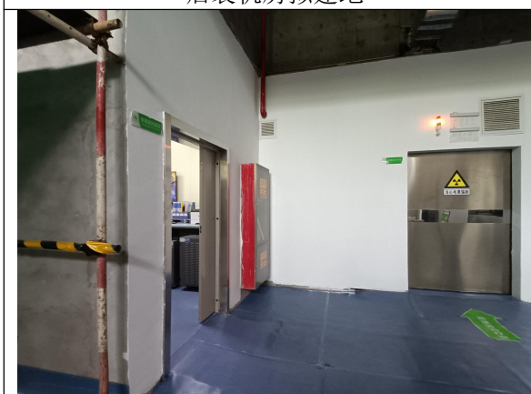
后装机房东北侧--直加机房及操作间
