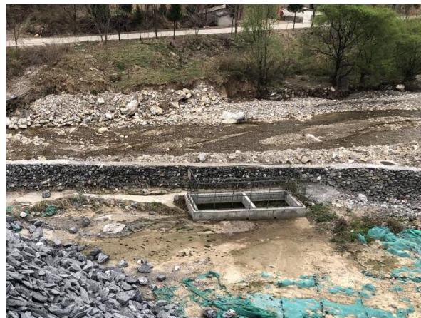
现有淋溶水收集池
