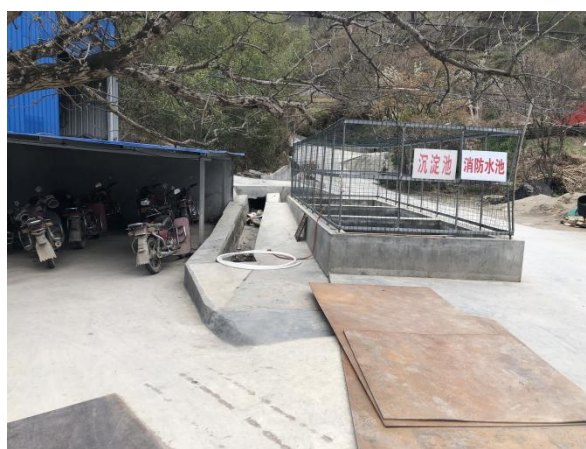
工业场地三级沉淀池
