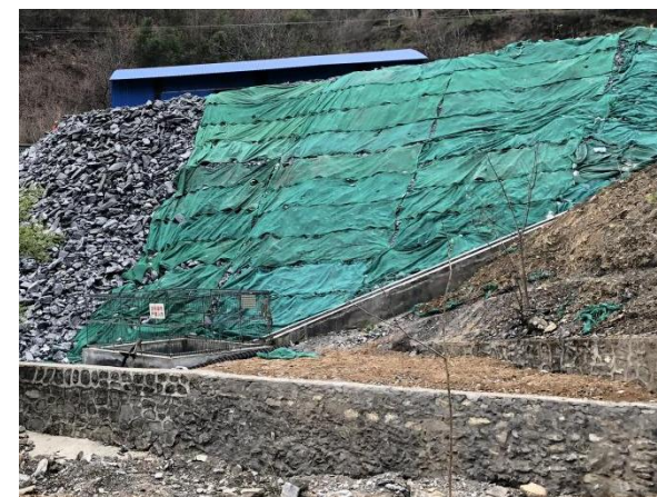
北侧排水沟及雨水收集池
