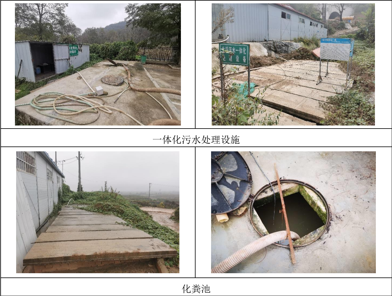
图6.1-1 施工期污水处理设施
