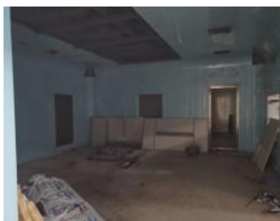
(4) DSA②机房内景
