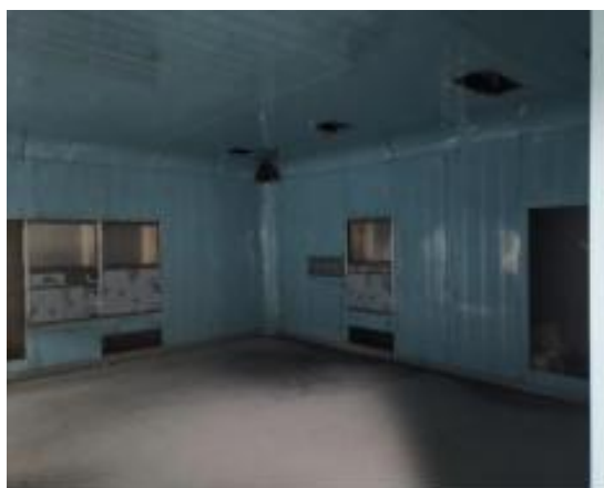
(3) DSA①机房内景
