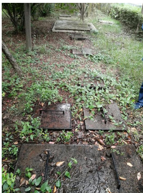
图 9.2-1 乾县 750kV 变电站污水处理设施照片
