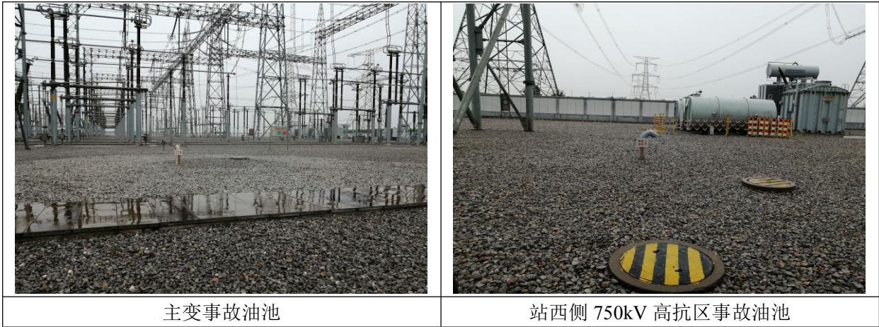
图 12.2-1 乾县 750kV 变电站内事故油池
