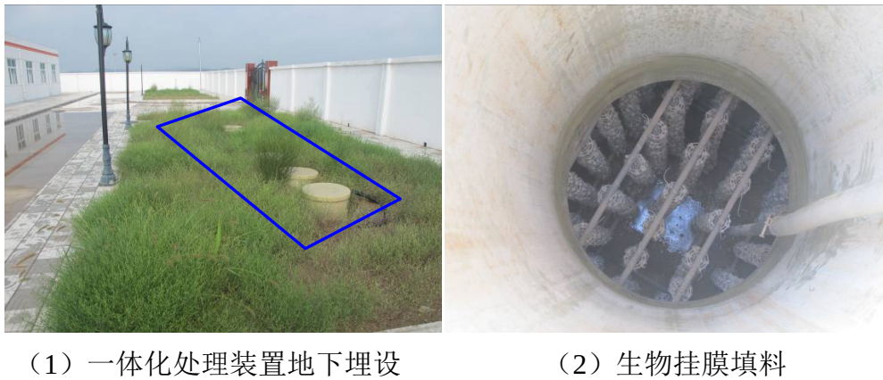
图 6.2-1 生活污水地埋式一体化处理设施
